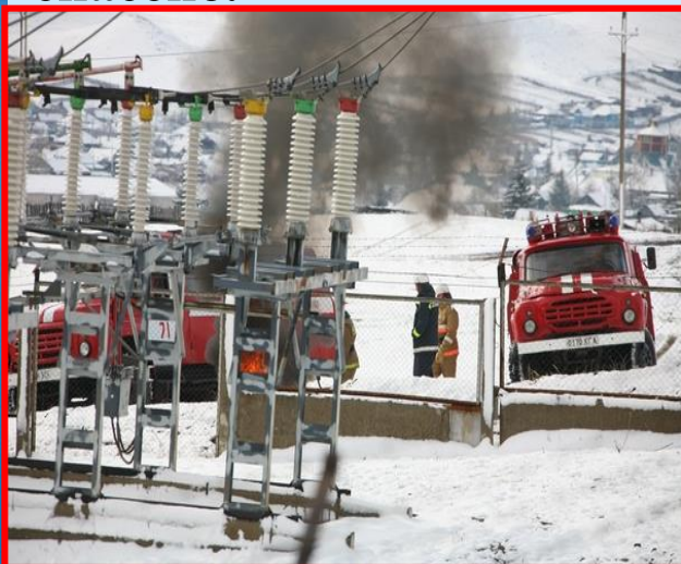
Нарушение энергоснабжения (описание) 0
